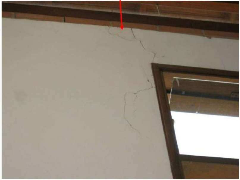
Fotografía 7. Mampostería fisurada en las esquinas de las aberturas.
