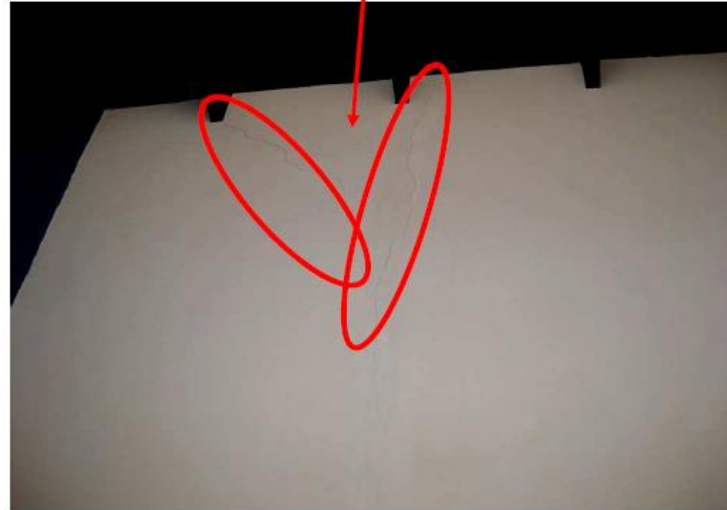
Fotografía 3. Mampostería fisurada en apoyo de tirantes.
